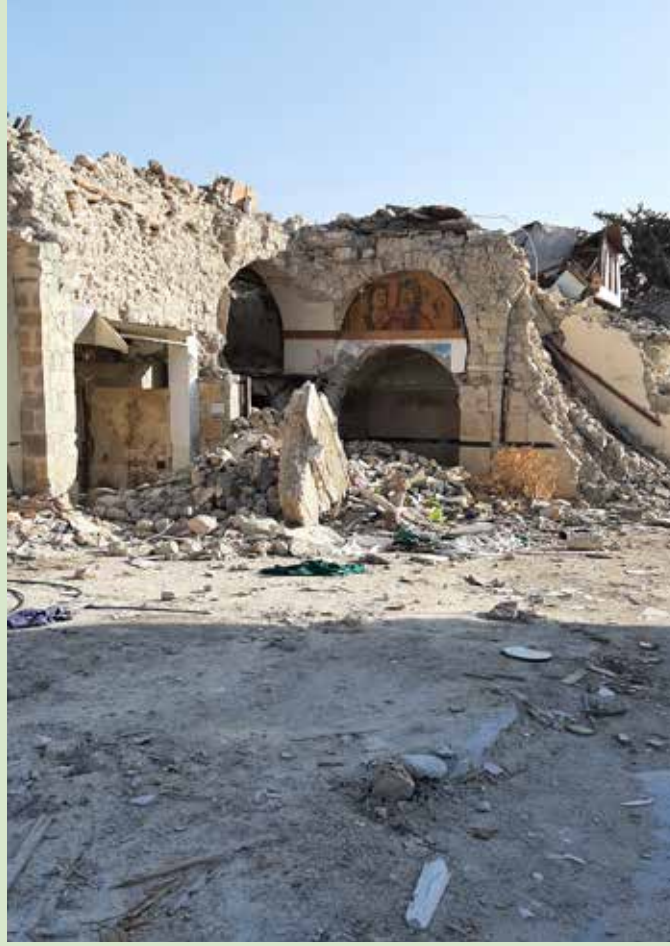
Yıkılan Antakya Ortodoks Kilisesi, Eylül-2023, Sema Bayraktar
