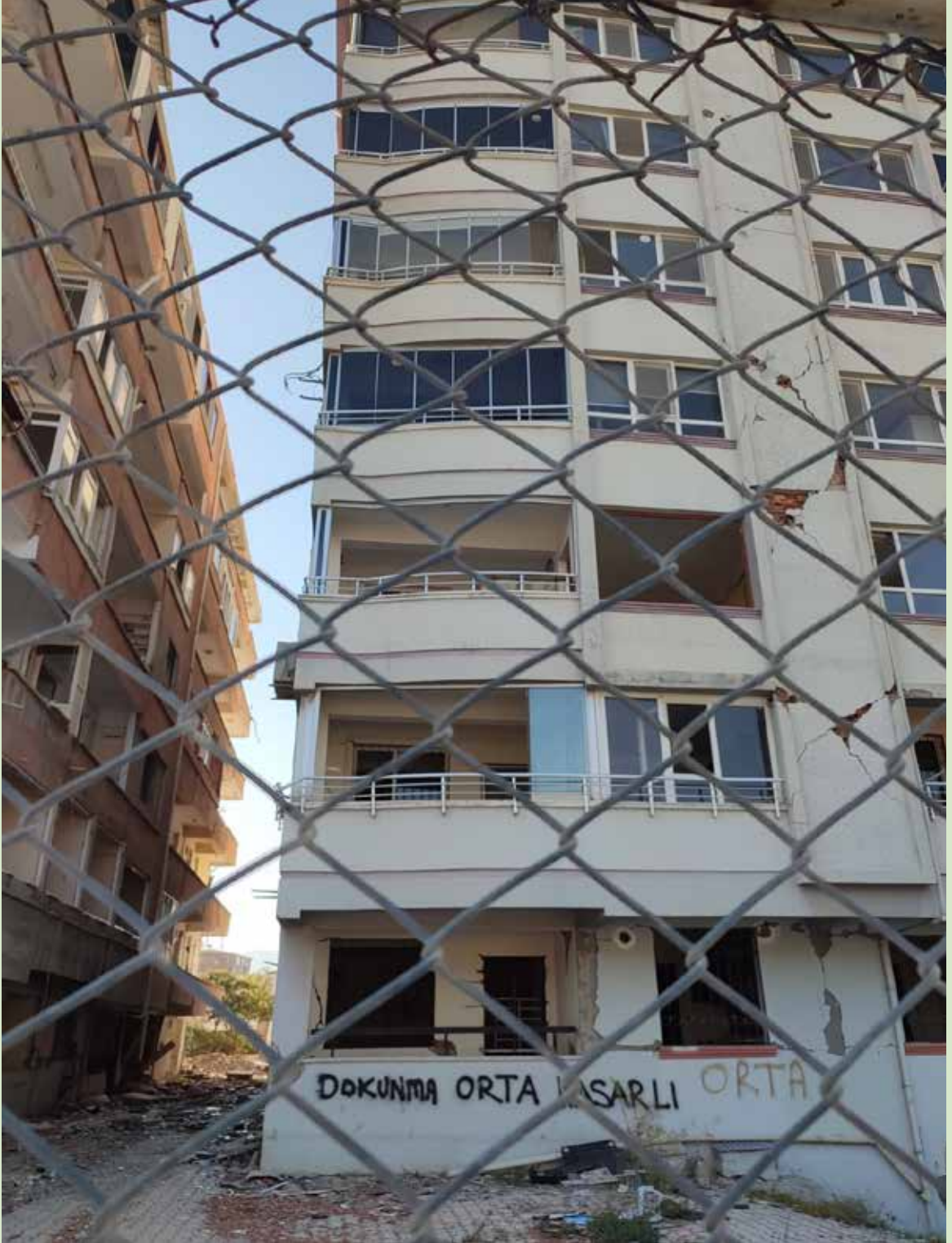
Armutlu Mahallesi, “Dokunma orta hasarlı”-Eylül-2023, Şafak Aykaç
